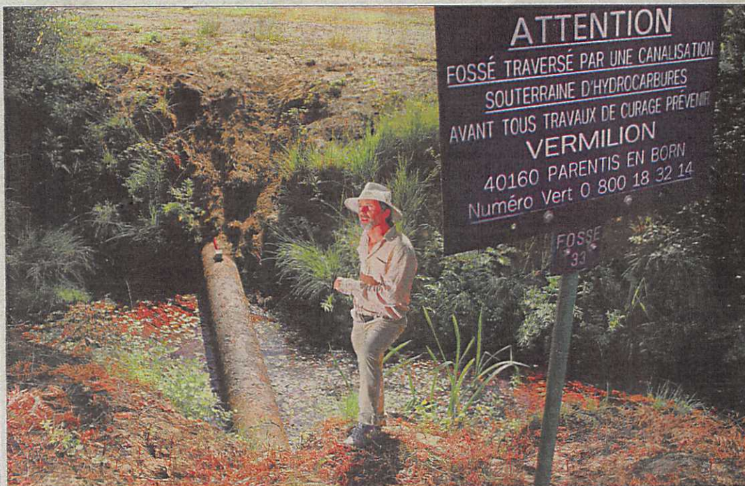
Pour Yves Jacquin Depeyre, le pipeline qui traverse sa propriété, présente des signes de corrosion. PHOTO FRANCK FERROGON
